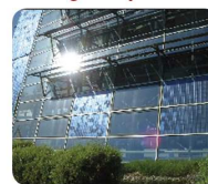
Intégration en façade (Solar Fabrik)
